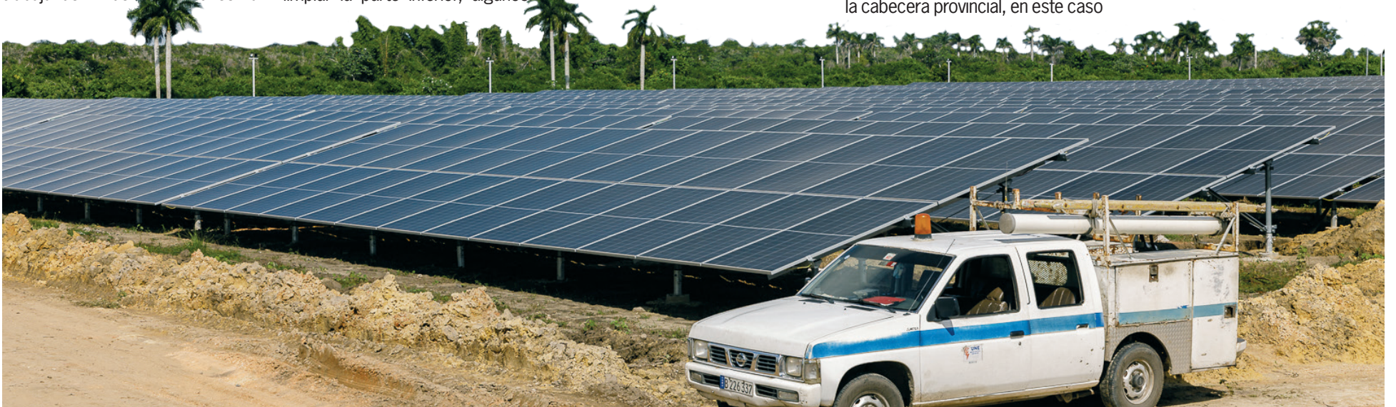
El nuevo parque cuenta con más de 9 000 paneles bifaciales de 600 watts
