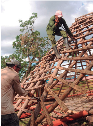
En San Diego la infraestructura tabacalera también fue dañada
