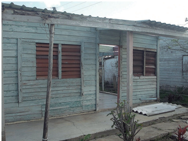
Los daños en el fondo habitacional de la comunidad El Sitio sobrecogen; 62 derrumbes totales y 71 daños parciales en un asentamiento de 136 viviendas
