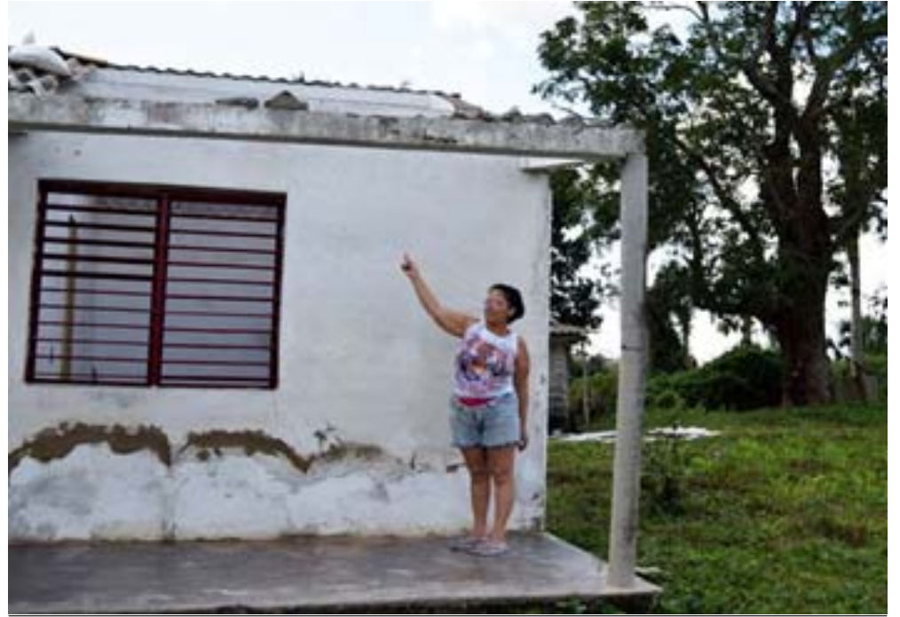
En el consejo popular Los Portales en Guane hubo daños en las viviendas fundamentalmente en la cubierta de las casas
